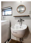
洗濯機の隣のスロップシンク。汗を吸った衣類の子洗いにもひげ剃りにも高いシンクは便利
