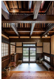
古の職人技を目の当たりにできる大きな吹抜け。ダイナミックな小屋組を確認できる
